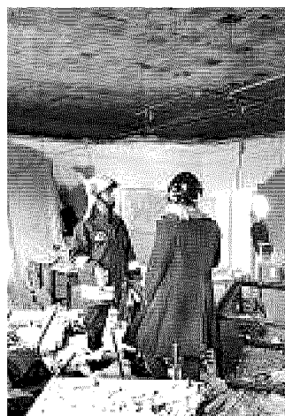
Il crollo al liceo Darwin
